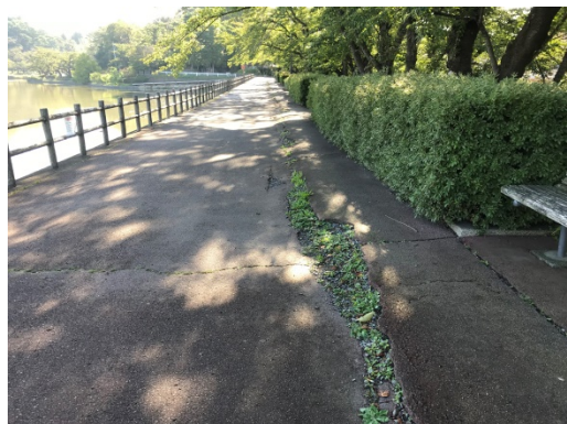
←高松の池に面して長く亀裂が入っている遊歩道
